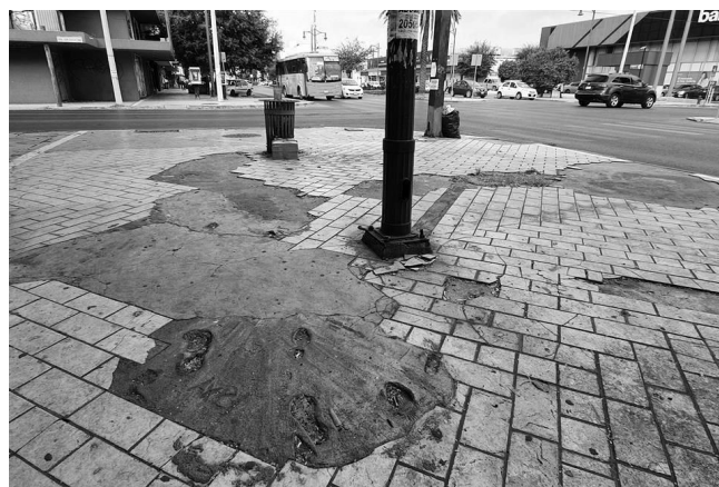
El estado deplorable de las banquetas perjudica el uso de la ciudad. El Norte.
